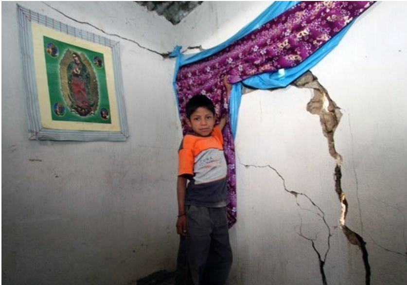
Un jeune garçon montre les dommages à son domicile résultant de la mine. Photo utilisée avec la permission du Comité de justice sociale de Montréal.
